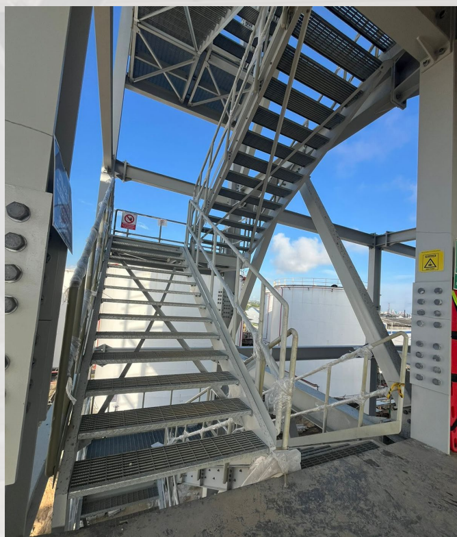
Escaleras de emergencia Adama Zona franca Barranquilla
